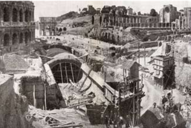
Figura 3 - Linea B – costruzione stazione Colosseo e galleria di linea verso Circo Massimo (1955)
